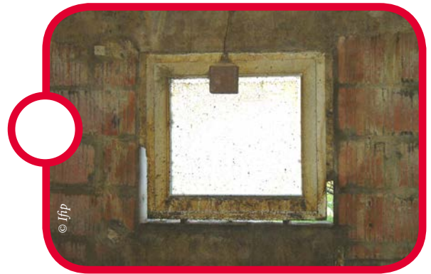
Entrée d'air parasite
