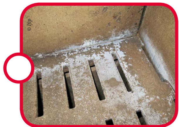
Développement de moisissures
