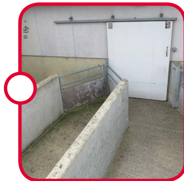
Quai sans arrivée d'eau
