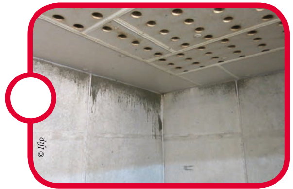
Humidité sur les parois
